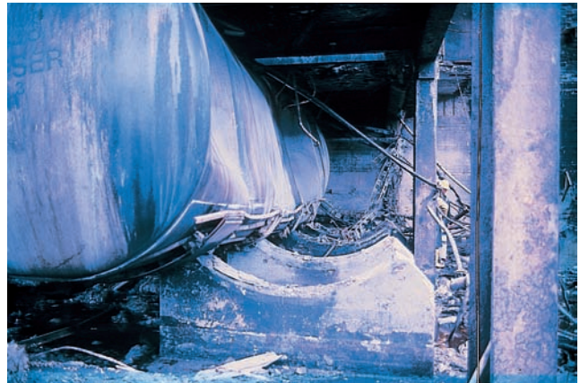
Abb. A/2-7: Schadensbild nach einer Blasenresonanzexplosion (Siedeverzug).
